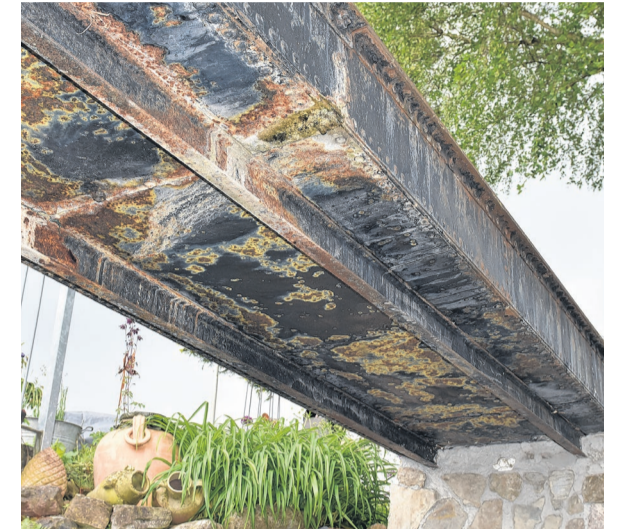
Der Zulaufkanal muss dringend saniert werden.
